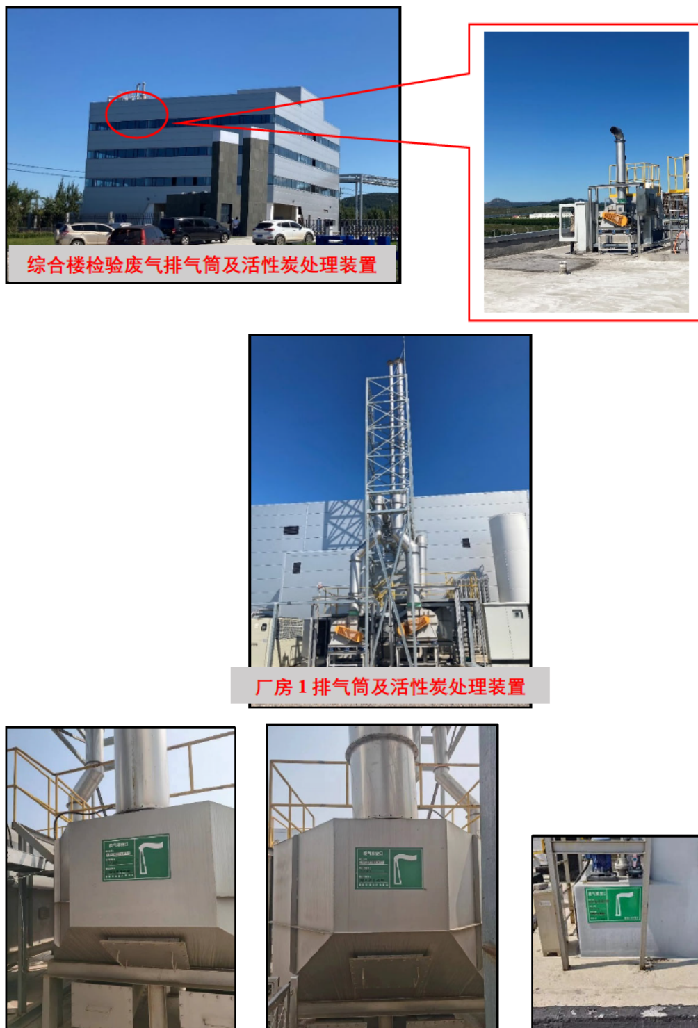
图 3.6 现有工程废气治理装置及排放口实景
