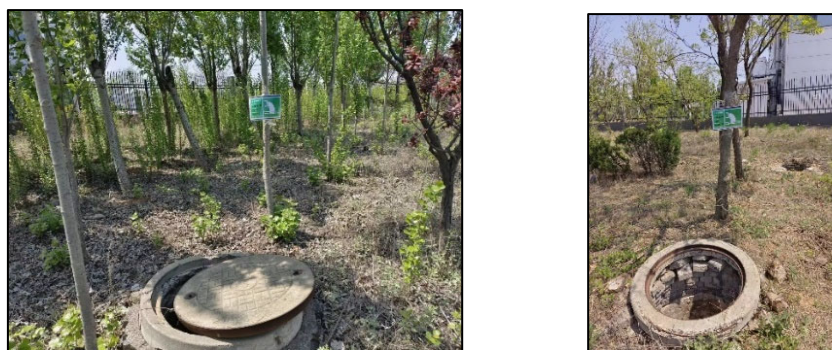
图 3.7 现有工程废水排放口实景
